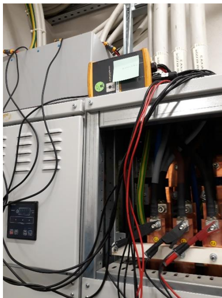
Slika 8 Prikaz vgrajenega analizatorja za izvedbo meritev.
